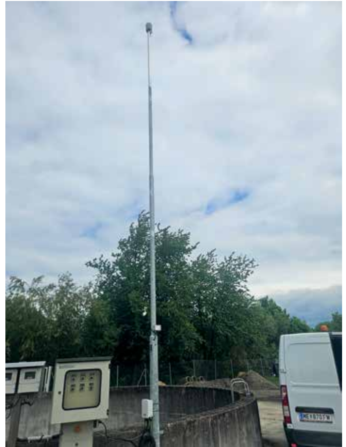
Die Wetterstation wurde in der Kläranlage montiert und ist für Bischofstetten nahezu kostenfrei.
